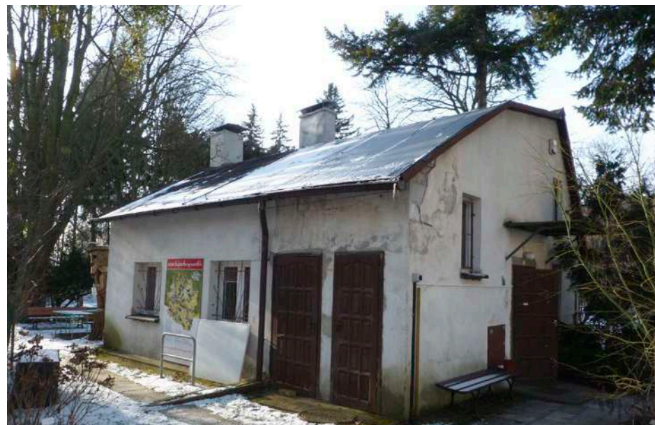
Fot. 15. Wymagający remontu budynek nad stawem z biurem i salką dydaktyczną, 2020 r. (fot. B. Waldon-Rudzionek)
