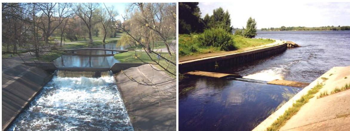
Fot. 2. Dwa stopnie wodne w ujściowym odcinku rzeki Zgłowiączki w celu zabezpieczenia koryta przed erozją wsteczną spowodowaną obniżaniem się dna koryta Wisły we Włocławku. Po lewej próg zbudowany ok. 300 m w górę od ujścia, po prawej drugi nowszy próg przy samym ujściu do Wisły.
