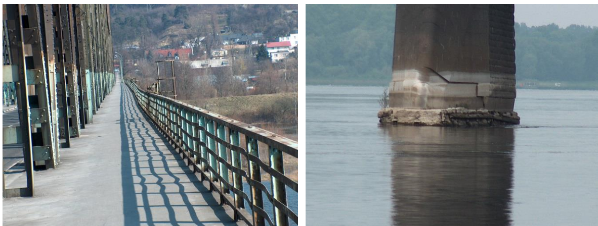
Fot. 1. Na fotografiach uwidoczniono efekty destabilizacji filarów mostu drogowego we Włocławku, zlokalizowanego około 5 km poniżej stopnia wodnego we Włocławku (fot. 2009).
