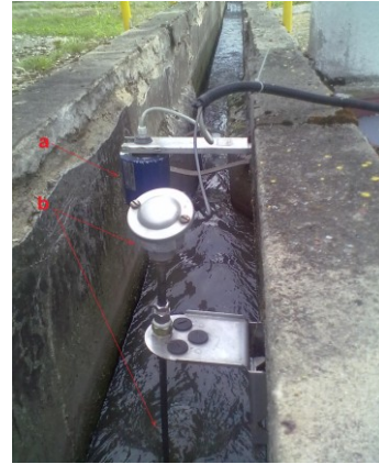
Rysunek 2 Urządzenie pomiarowe zainstalowane na oczyszczalni w Łądku-Zdroju.
